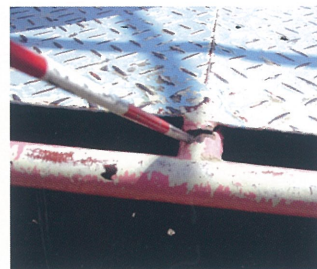
荷重のかかる溶接部
